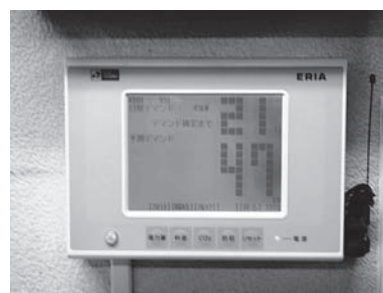
資料3 デマンドコントローラーによって電気使用量を大幅削減
